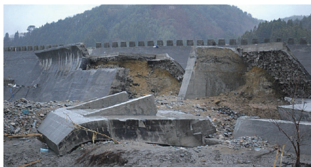
津波で破壊された田老地区の防潮堤
